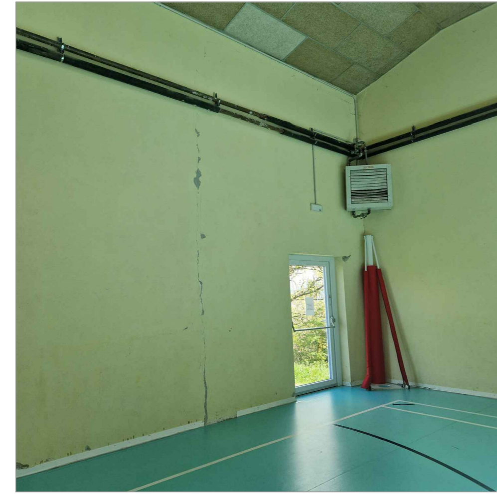
Vista su interno - Lesioni da ripristinare
