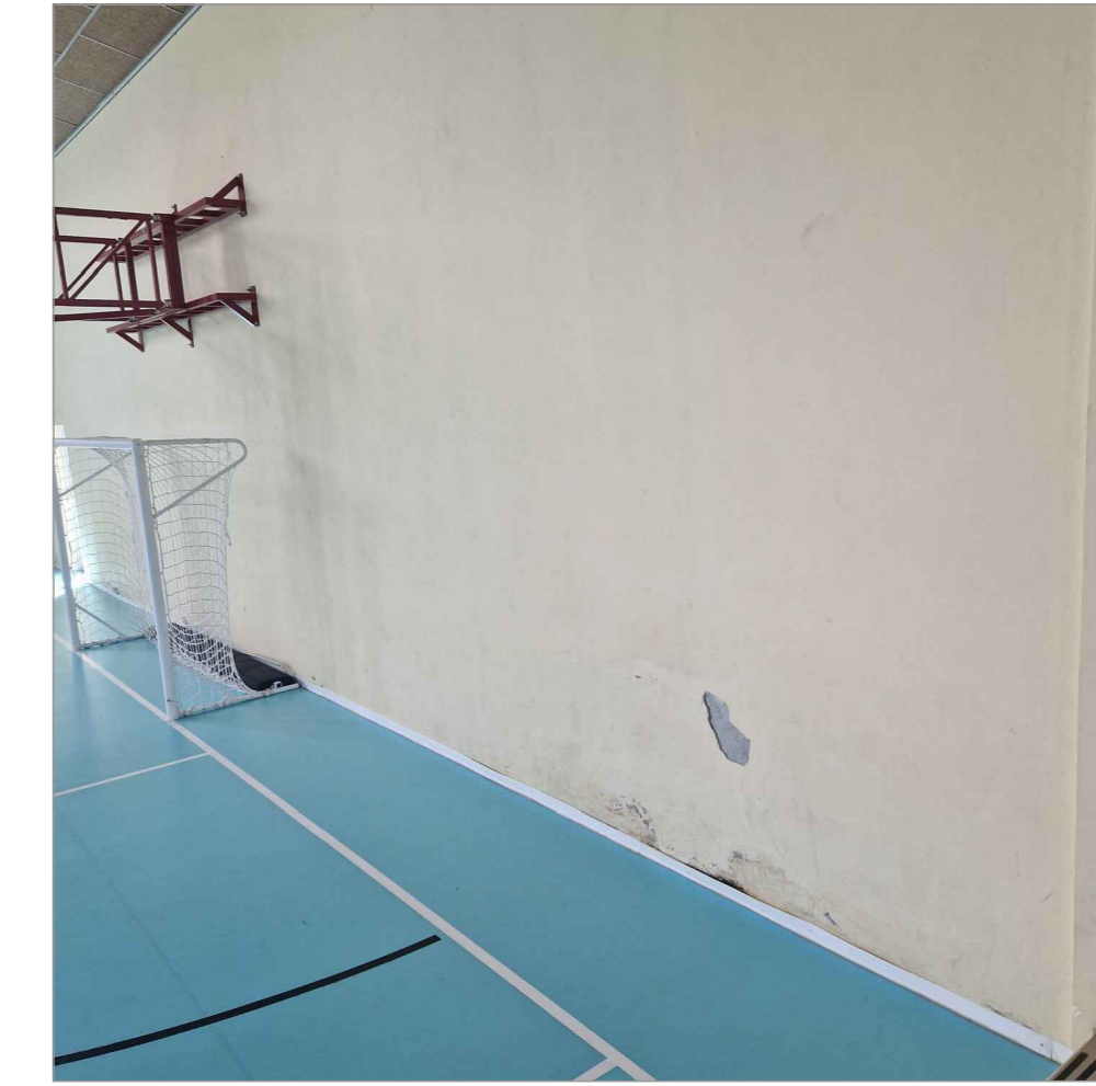
Vista su interno - Risanamento pareti con risalita di umidità
