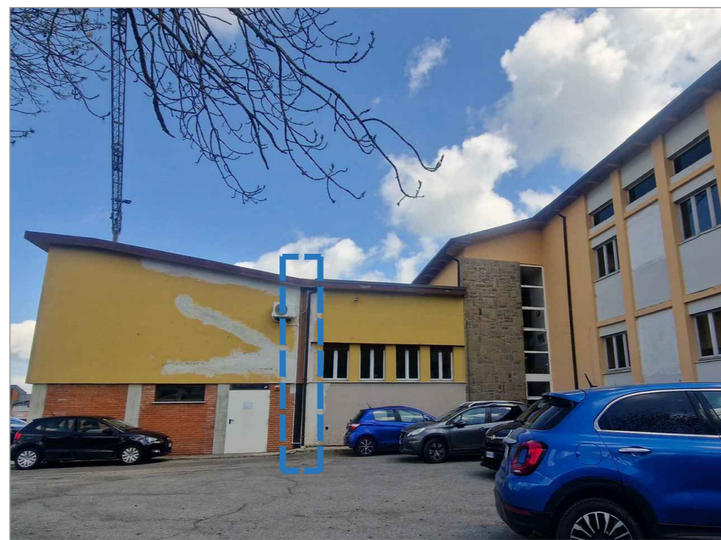
VISTA LATO OVEST – Giunto da revisionare e lesioni da ripristinare
