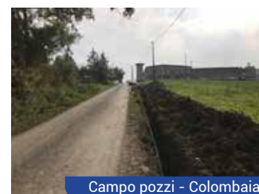
Campo pozzi - Colombaia
